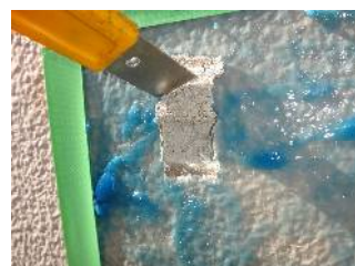
塗膜の軟化状態の確認 皮スキなどで塗膜の軟化状態を確認する。
